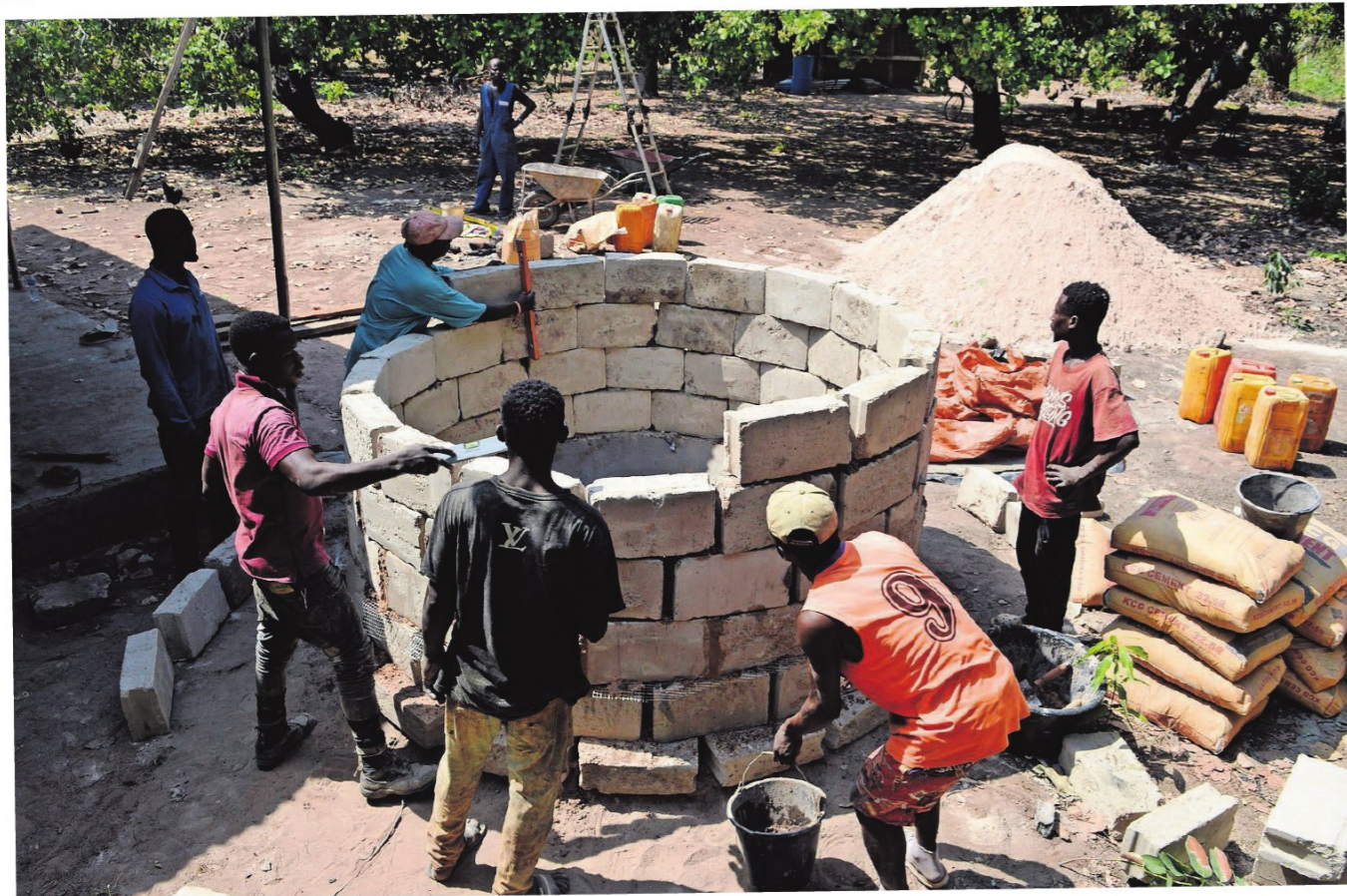
▲ Inwoners van een Ghanees dorpje bouwen een eigen Calabash Cistern. FOTOS TOMMIE VAN ESSEN
